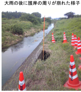
大雨の後に護岸の周りが崩れた様子
